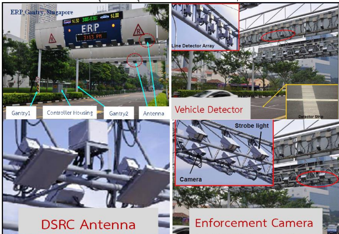
แผนภาพที่ 3-18 อุปกรณ์ควบคุมจราจรและองค์ประกอบต่าง ๆ ของเทคโนโลยี ERP
