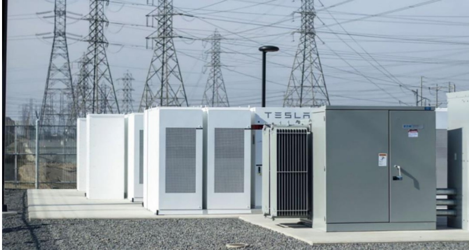
แผนภาพที่ ๔ – ๑๐ ระบบกักเก็บพลังงาน (Energy Storage)
