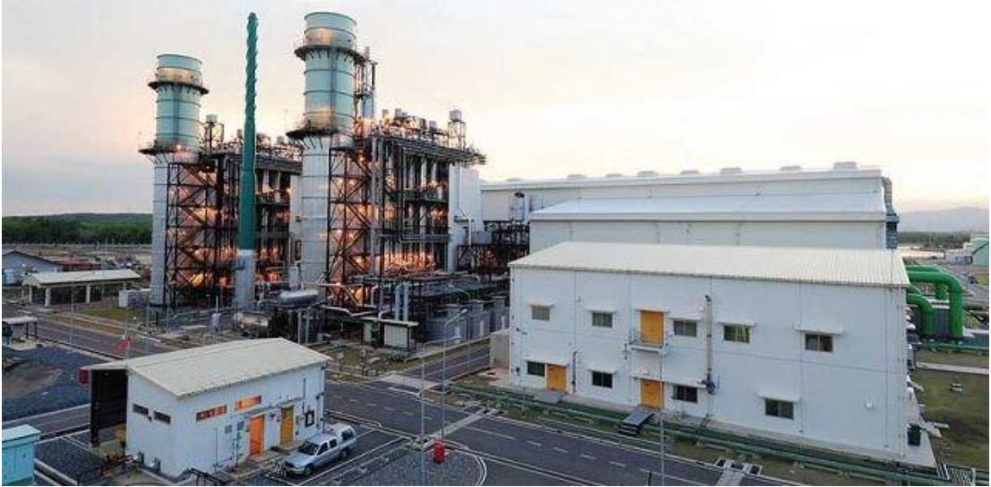
รูปภาพที่ ๓ - ๓ โรงไฟฟ้าจะนะ จังหวัดสงขลา
