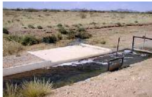
(ข) บานเลื่อนที่ใช้ผันน้ำเข้าพื้นที่โครงการ
