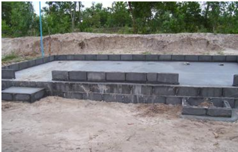
แผนภาพที่ 3-11 เทคอนกรีตพื้นห้องน้ำและก่อสร้างผนังบล็อกสูง 1 แถวตามแบบที่กำหนดไว้
