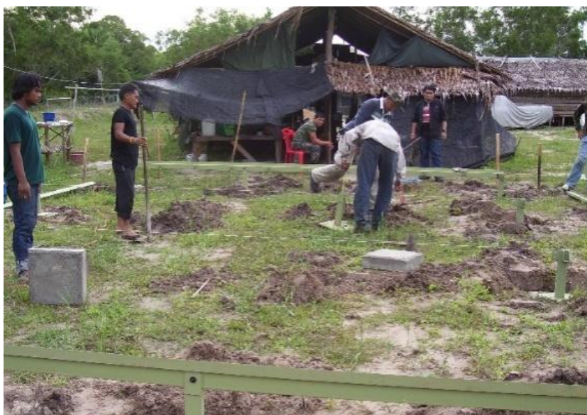
แผนภาพที่ 3-5 การปรับพื้นที่ กำหนดตำแหน่งและวางผังอาคารที่พักอาศัยสำเร็จรูป
