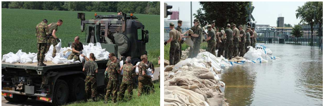
แผนภาพที่ 4-30 แนวกันกั้นน้ำที่ถูกสร้างด้วย Big Bag และกระสอบทราย
