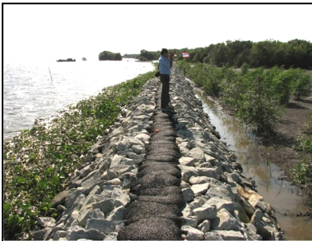
แผนภาพที่ 2 - 19 กำแพงป้องกันคลื่นใกล้ชายฝั่งแบบหินทิ้งหรือหินเรียงฐานรากเข็มสน บริเวณบ้านสีลัง ตำบลสองคลอง อำเภอบางปะกง จังหวัดฉะเชิงเทรา
