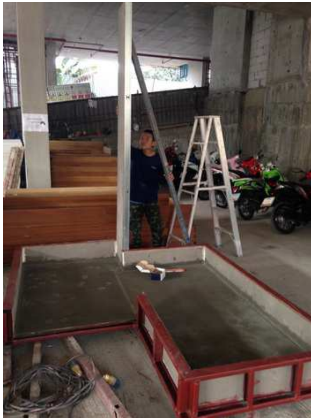
แผนภาพที่ 4-8 การประกอบโครงผนังเข้ากับ โครงพื้นห้องน้ำ
