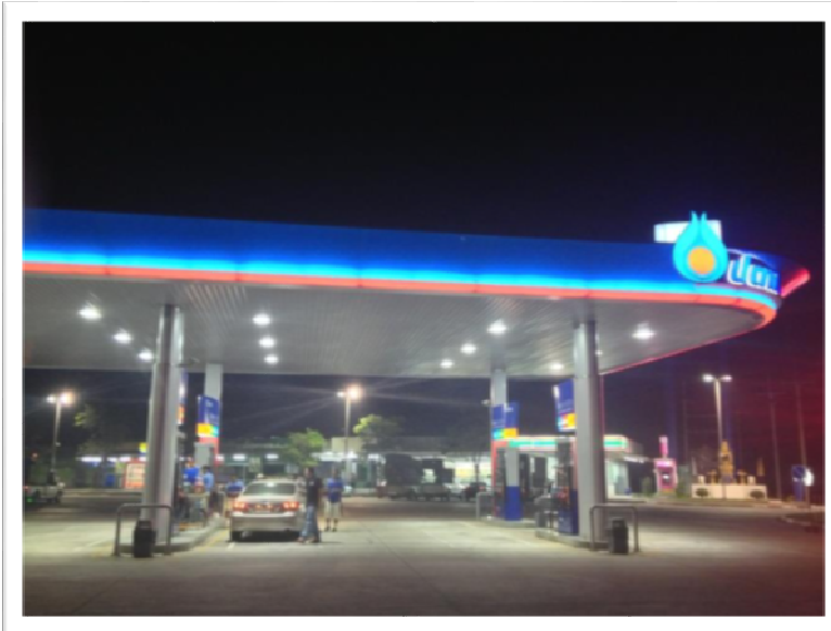
ภาพที่ 4-11 ตัวอย่างการติดตั้งหลอด LED ที่สถานีบริการน้ำมัน
